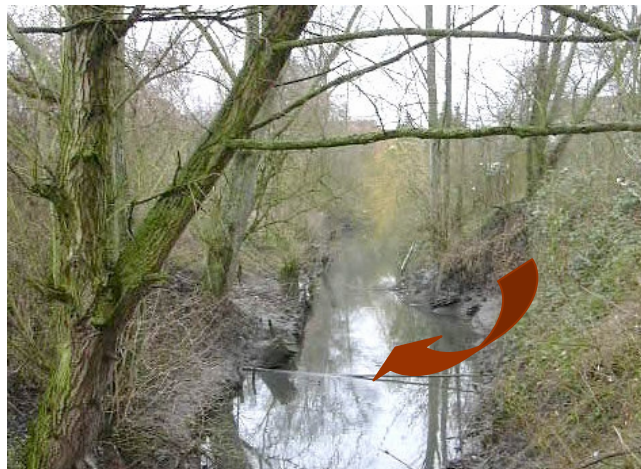
Photo 2 : Berges déstabilisées par glissement en rive droite en aval immédiat du pont du parc de Beuvry
