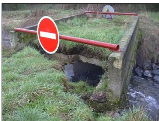
Photo 17 : Déstabilisation d'un pont en aval de Mazingarbe
