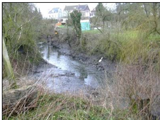
Photo 14 : Déstabilisation des berges de la Loïsne
